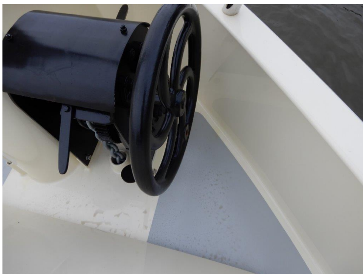
Pen bij mijn tweede inspectie gedemonteerd. Het jaagwiel, ankerwinch, is niet te bedienen
